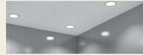
Cielo raso con luces LED
